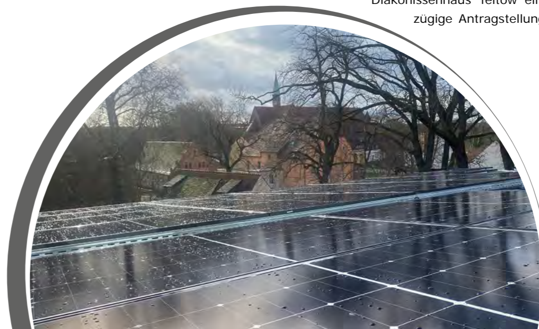
Photovoltaikanlage auf der Klinik für Geriatrische Rehabilitation in Lehnin
